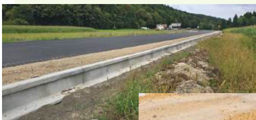
Vgrajene usmerjevalne ograje
